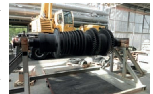
Demontierter Dampfturbinenläufer kurz vor dem Abtransport zur Generalüberholung
