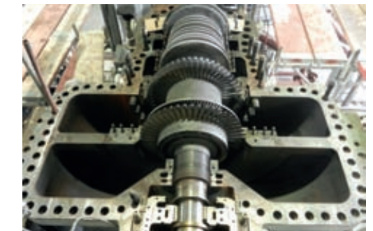
Dampfturbinenläufer im Unterteil des Gehäuses in der Dampfturbine
